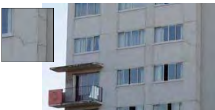
Fissures sur l'ensemble de la façade qui favorisent la pénétration d'agents pathogènes.
