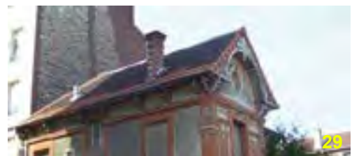
1 rue Désiré Lelay. Les tuiles de rive et celles au-dessus de la ligne d'égout ne sont pas de la même couleur que l'ensemble de la toiture
