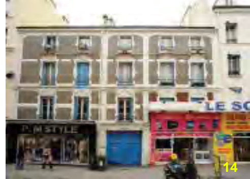
14 - La devanture qui s'impose sur un demi-niveau du premier étage nuit à la composition d'ensemble de la façade.
