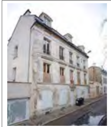
Façade principale et mur pignon nord © Jacques MANGIN – UASD – Département de la Seine-Saint-Denis
