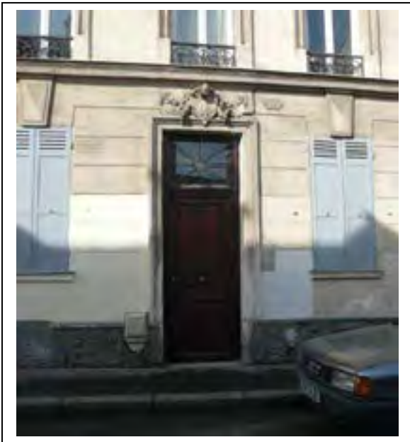
Détail de la porte d'entrée et des persiennes en rez-de-chaussée. Département de la Seine-Saint-Denis, DCPSL, SPC
