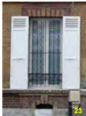
Le barreaudage aux lignes ondulées est trop visible et nuit à la perception générale.
