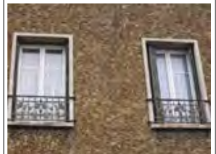
Parement en pierre de meulière de type rocaille contrastant avec les encadrements maçonnés blancs
