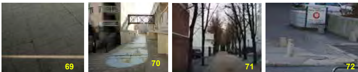
Les dalles en ciment se retrouvent à rez-de-voir sur la place du Caquet et au niveau des dalles. Les fissures et éclats nuisent à la perception de l'espace.
