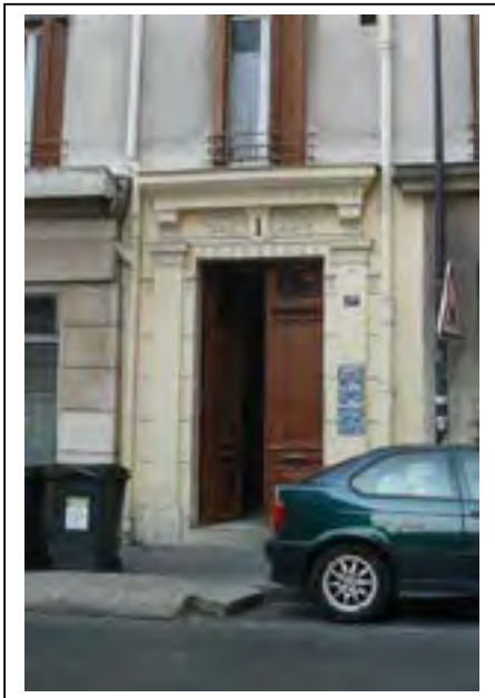
Détail de la porte et de son encadrement au n°1 ter : se sont les rares éléments de second œuvre conservés sur les façades de cet immeuble. Département de la Seine-Saint-Denis, DCPSL, SPC
