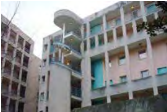
Salissures noires plus marquées aux endroits où ruisselle l'eau (au niveau des appuis par exemple)
