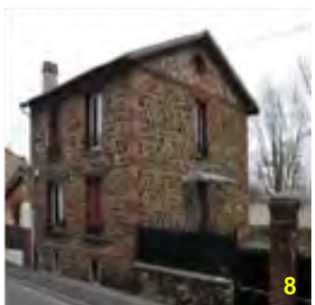
Appareillage « réglé » et joints beurrés qui donnent un rythme continu à la façade façon « nid d'abeilles »
